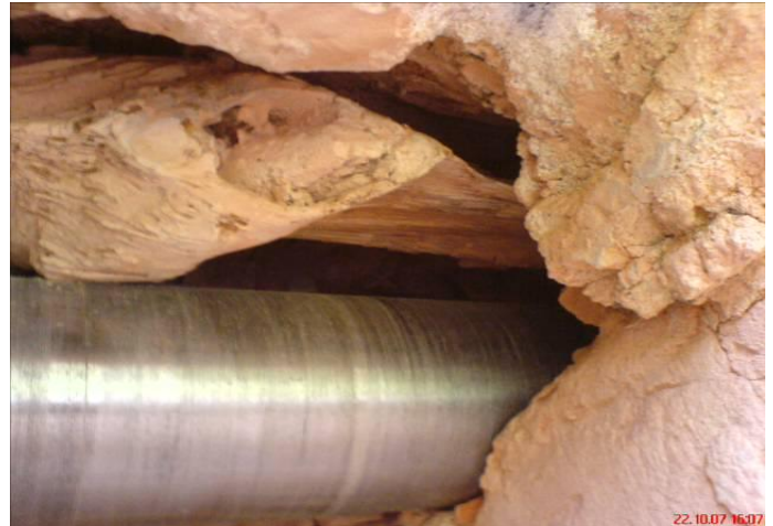
Abb. 2 : Inhomogenes Bestandsmauerwerk mit Bohrhindernissen
