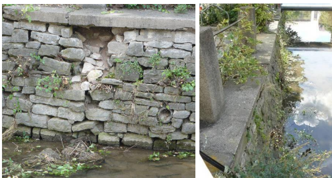
Abb.: Loses Mauerwerksgefüge, stark mit Grün durchwachsen
