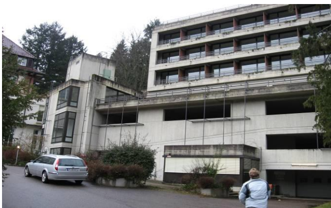
Abb. 1 - Klinik vor der Instandsetzung
